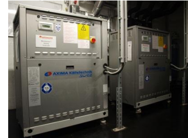
Wärmepumpe-1 Heizung Greencube
